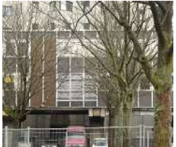
Aspect actuel des grilles de ventilation
